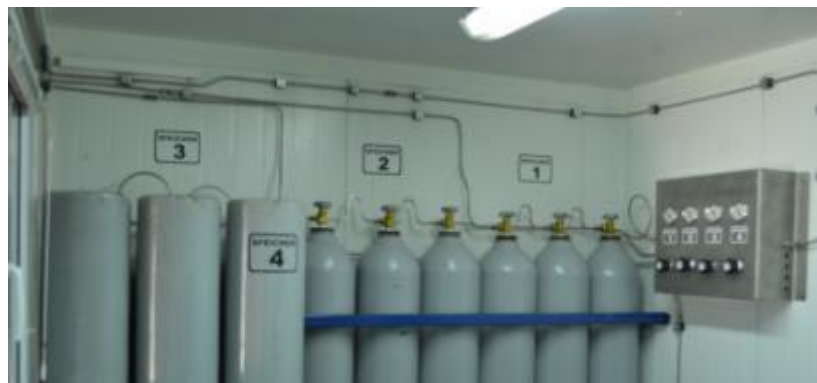
SPEICHERANLAGE EIGENE HERSTELLUNG
