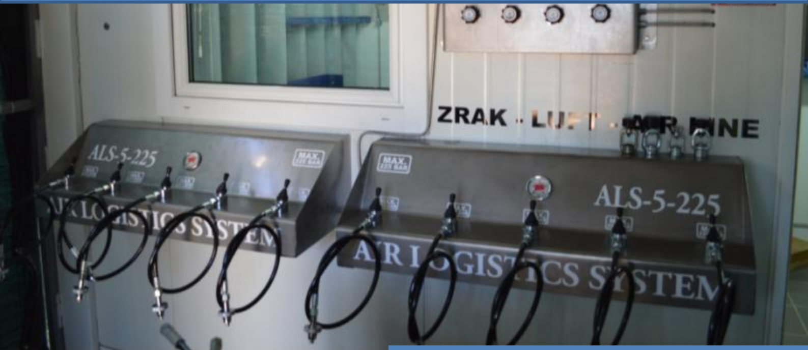
FÜLLRAMPE 225 BAR EIGENE HERSTELLUNG
